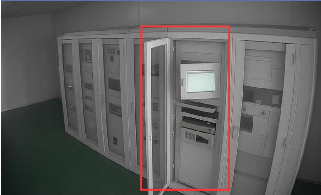
设备未正常关闭
