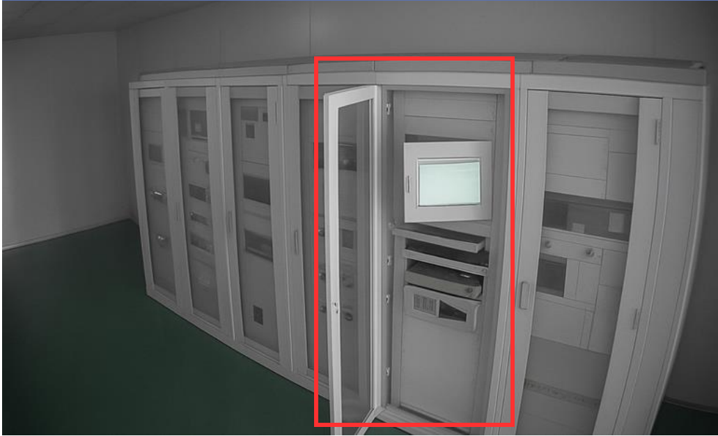
设备未正常关闭
